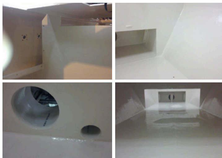
Tanques flotantes de laminación
